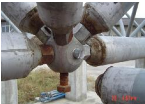
شکل ۳: دو نمونه از گسیختگی در جوش و پیچ.
